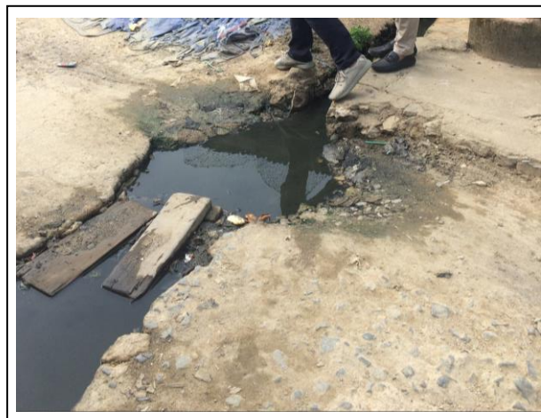
Gambar 5. Contoh Kondisi Permukaan Jalan Lingkungan yang Rusak
