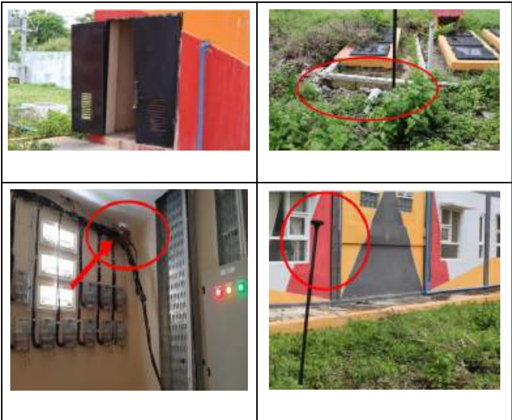
Gambar 3.9 Foto Kerusakan Utilitas
