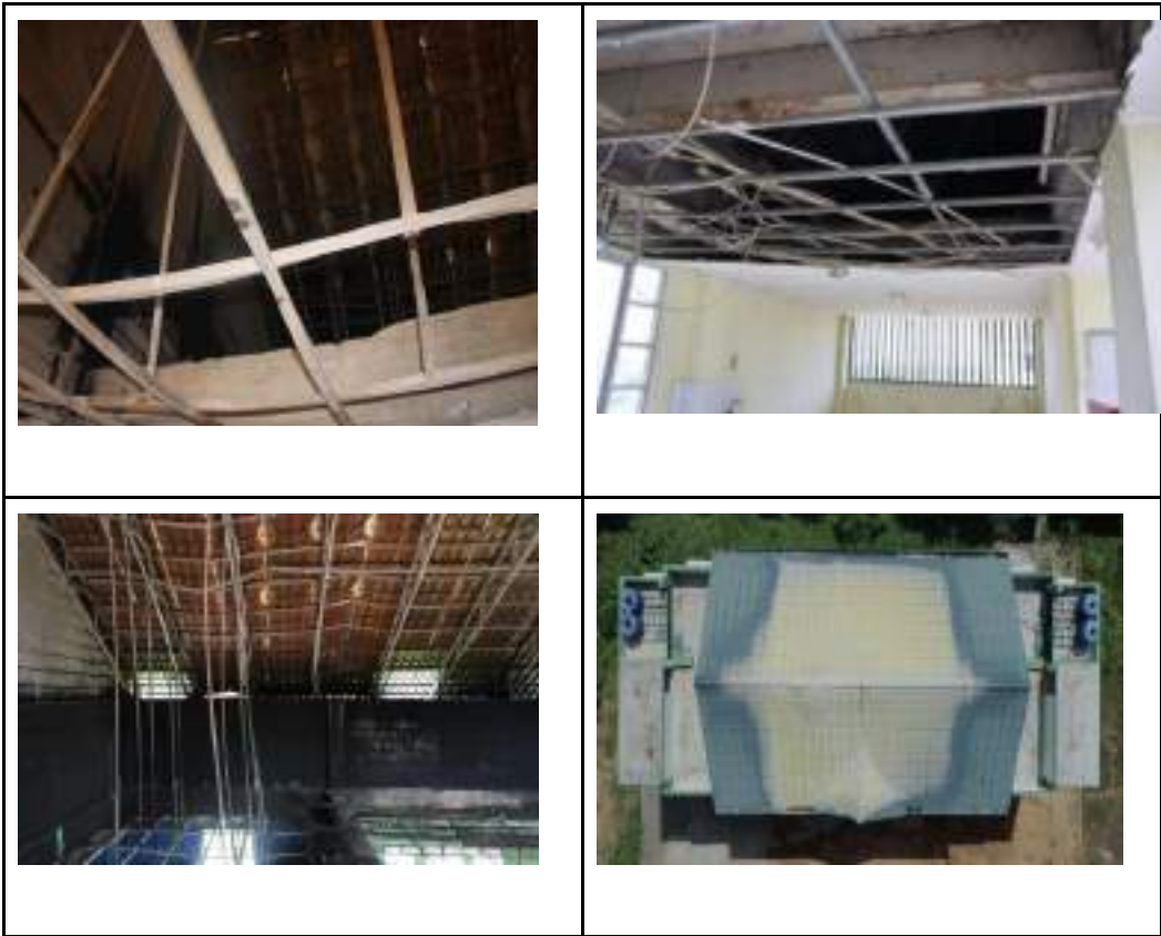
Gambar 3.5 Foto Kerusakan Atap
