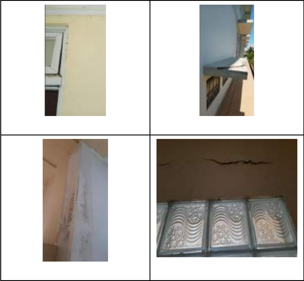
Gambar 3.7 Foto Kerusakan Dinding
