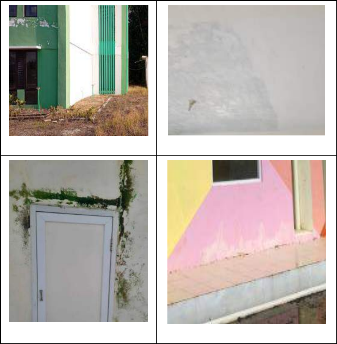
Gambar 3.10 Foto Kerusakan Finishing
