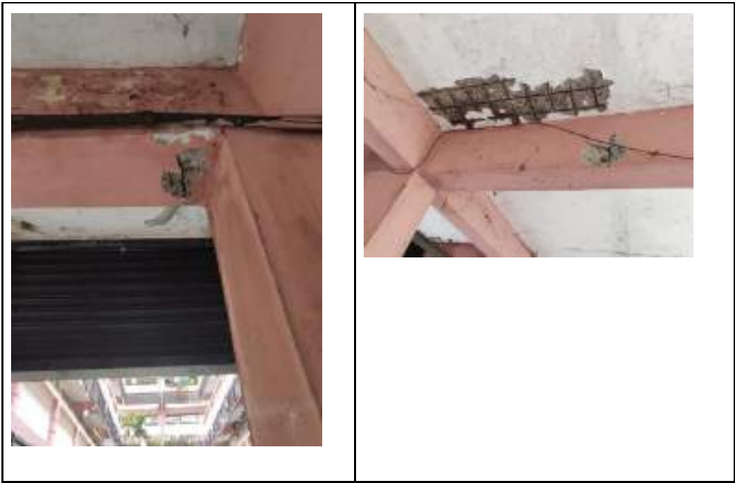
Gambar 3.4 Foto Kerusakan Kolom, Balok, dan Ring
