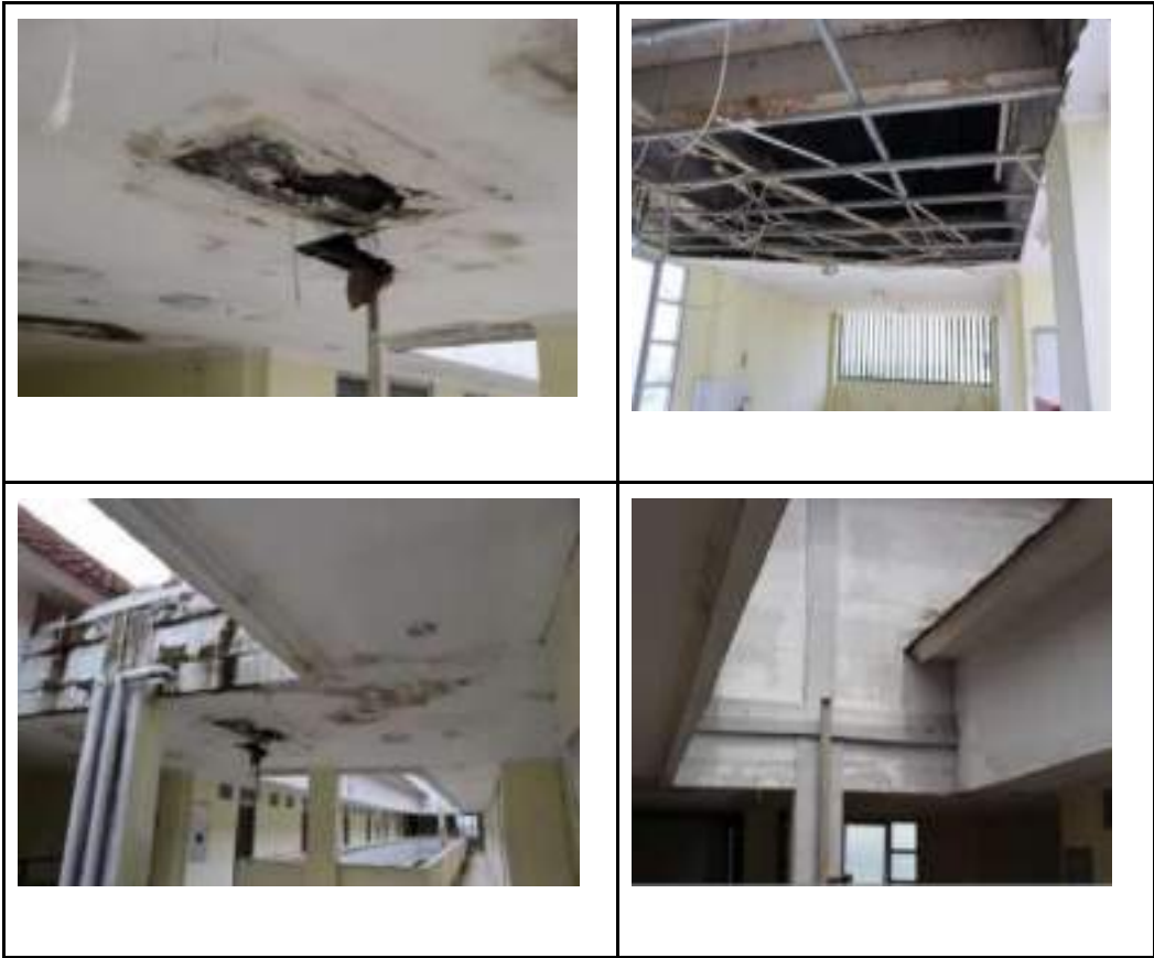
Gambar 3.6 Kerusakan Langit – Langit
