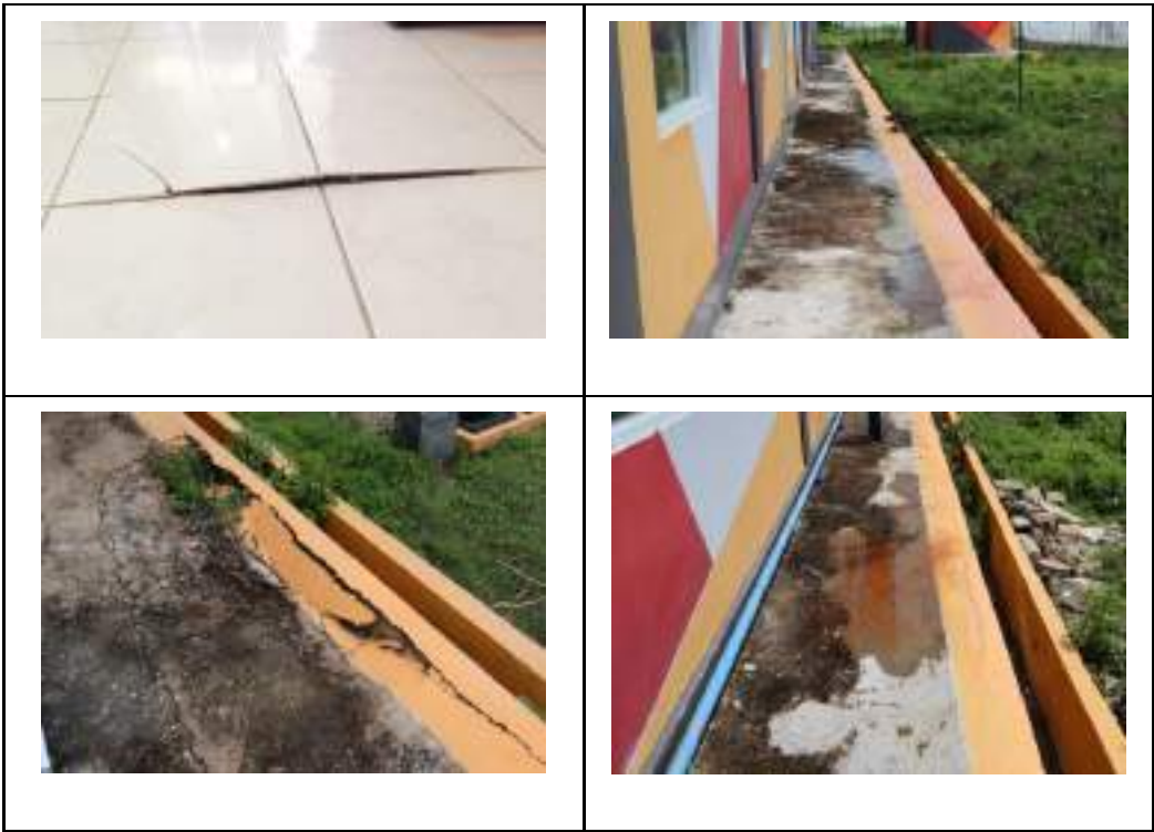
Gambar 3.8 Foto Kerusakan Lantai
